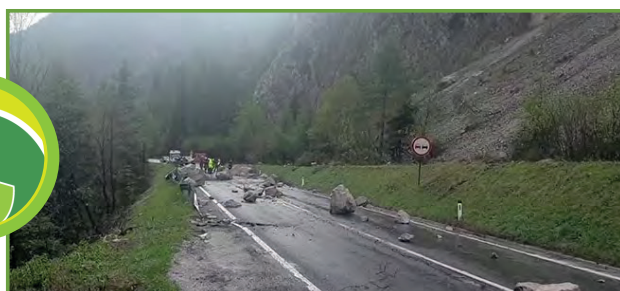
L'absence d'obstacles aux chutes de pierres augmente le risque d'accidents et de fermetures de routes.
